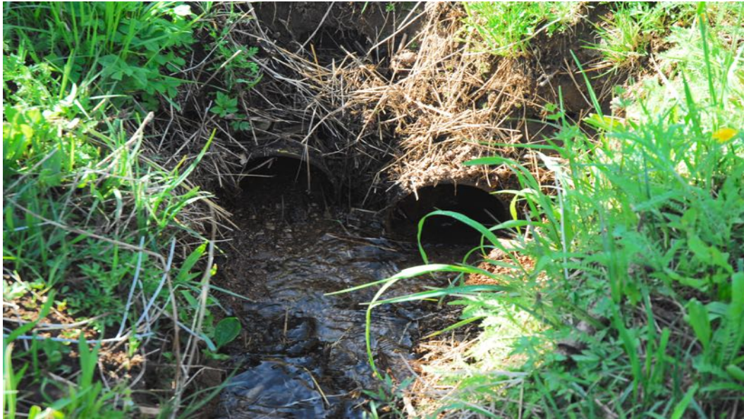
Figura 7. Dettaglio due tubi di drenaggio (diametro di 20 cm).
