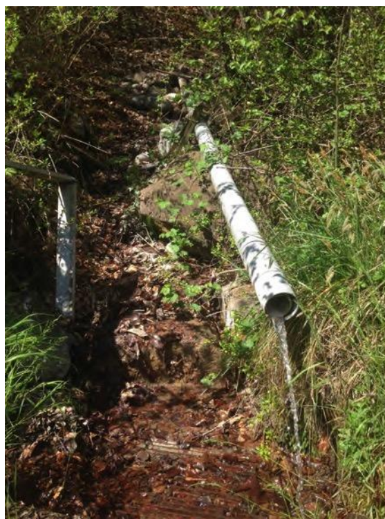
Figura 2.12.2. L'acqua dell'affluente viene fatta defluire in una tubazione e successivamente in una sorta di tombino per il passaggio sotto la strada.
